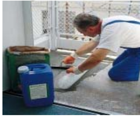
гидроизоляция балкона MAPELASTIC с использованием армировочной сетки из стекловолокна (ячейка 4 x 4 см)
